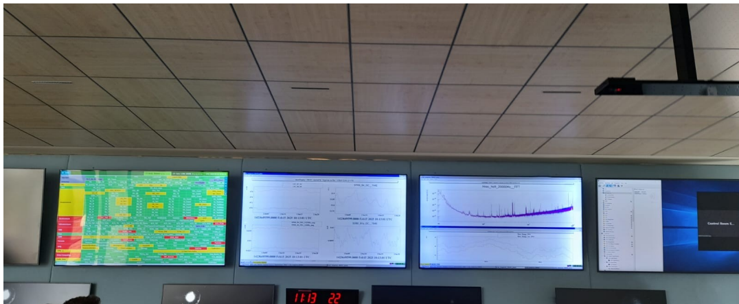
Fig.13: Control room per acquisizione delle onde gravitazionali
